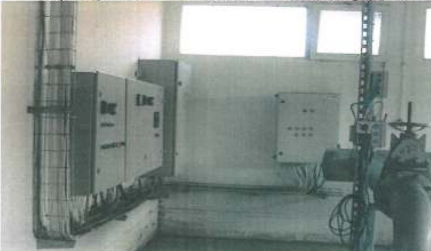
4. Stația loșia Nord - Panouri Tehnosam (stânga) și IMSAT (dreapta)
